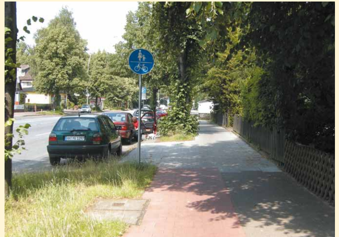
... Problemstellen bleiben bei reiner Oberflächensanierung aber bestehen und beeinträchtigen Sicherheit und Komfort.
